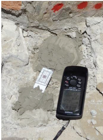
Fig. 8 – Controllo di fessurazione nel centro abitato mediante fessurimetri, distanziometri laser e GPS.
